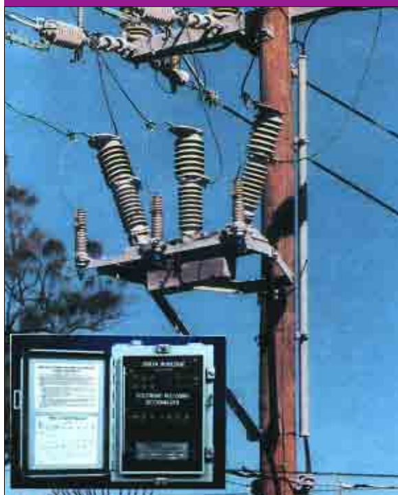
Fig. 2. Reanclanșator de secționare cu transformatoare de tensiune și dispozitivul digital cu logică Tensiune – Timp
